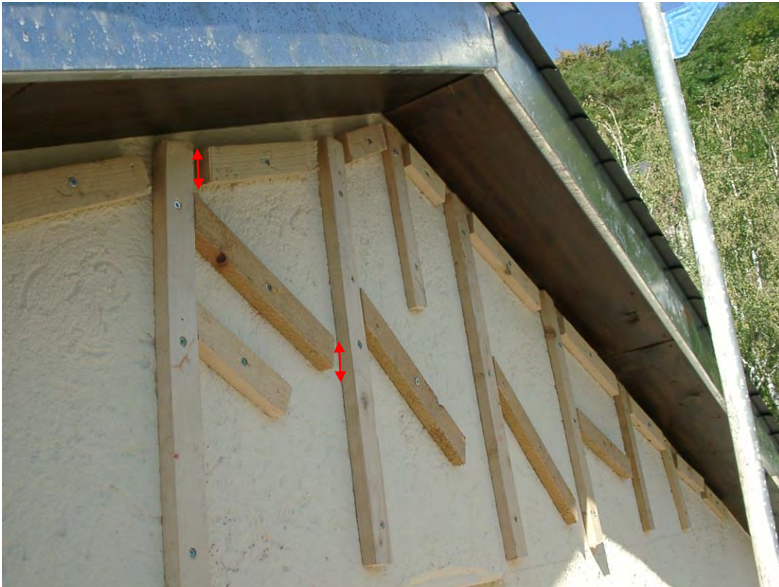
Abb. 10: An den Giebelseiten wurde eine Nut-Federverschalung mit spezifischer Lattenkonstruktion hergestellt, so dass die Muttertiere ihre Jungtiere auf die Dachlatten ablegen können, nicht aber sich Kot ansammeln kann. Die Fledermäuse müssen innerhalb der Lattenkonstruktion überall hin krabbeln können, so sind an allen Latten „Durchlässe“ (rote Pfeile als Beispiel von Durchlässen) vorzusehen, so dass keine Barrieren/Sackgassen entstehen.
