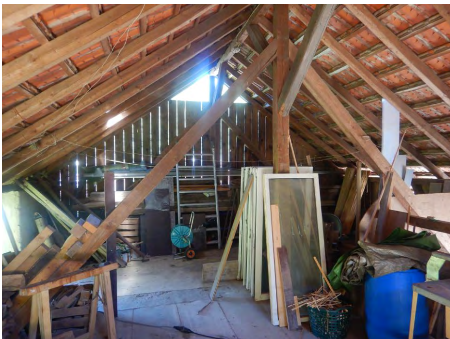
Abb. 7: Dachstuhl mit zahlreichen Spalten und Nischen als potenzielle Lebensstätte von Fledermäusen.
